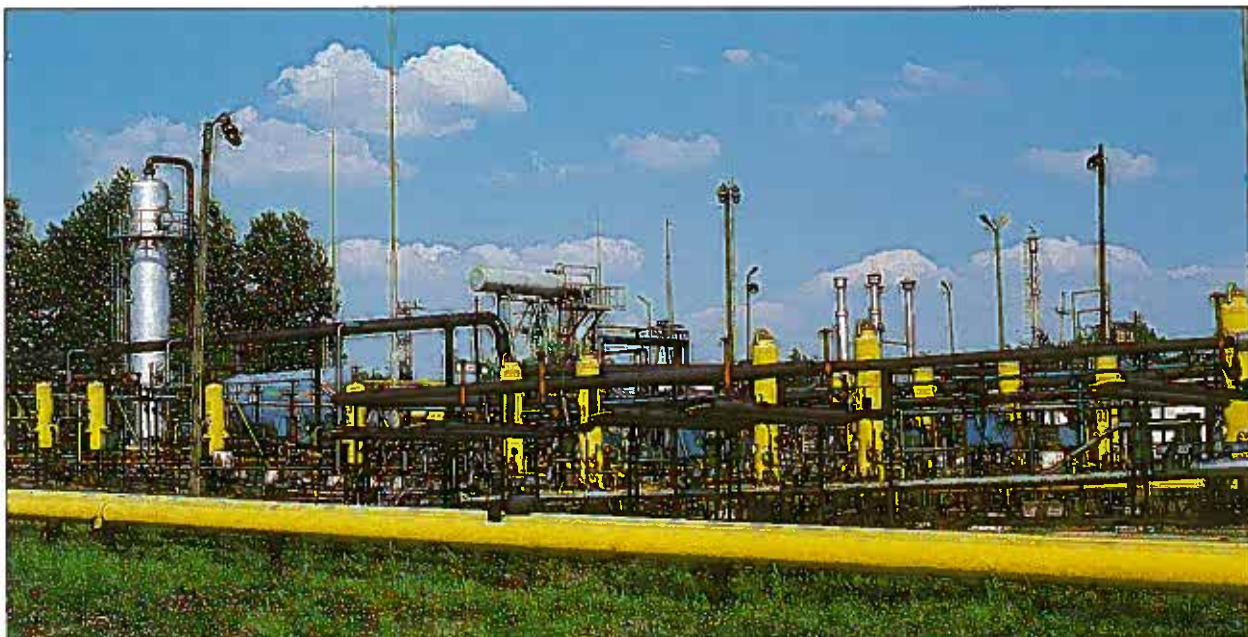
Typowa instalacja gazowa PGNiG
