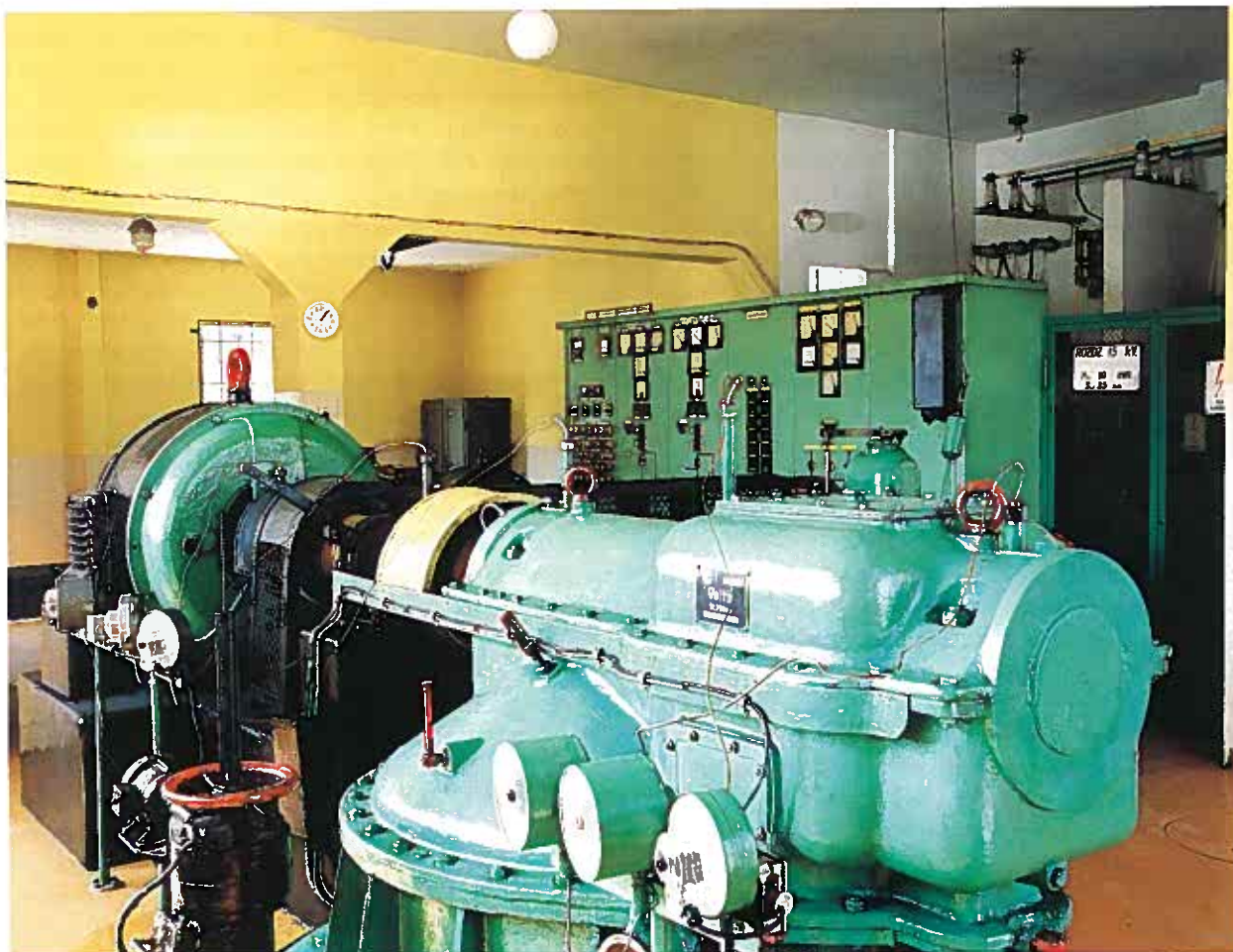
Hala maszyn Elektrowni Wodnej Smoldzino
