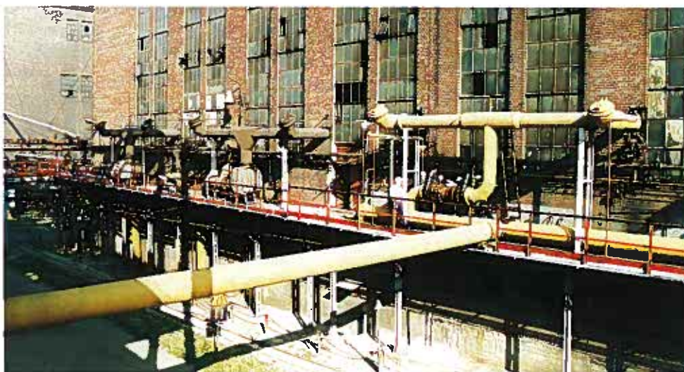
Instalacja odsiarczonego gazu koksowniczego w „Elektrociepłowni Marcel” Sp. z o.o. w Radlinie
