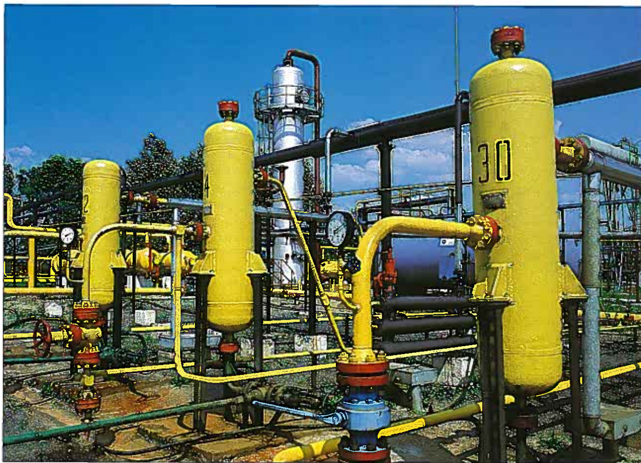
Instalacja kopalni gazu ziemnego PGNiG S.A.
