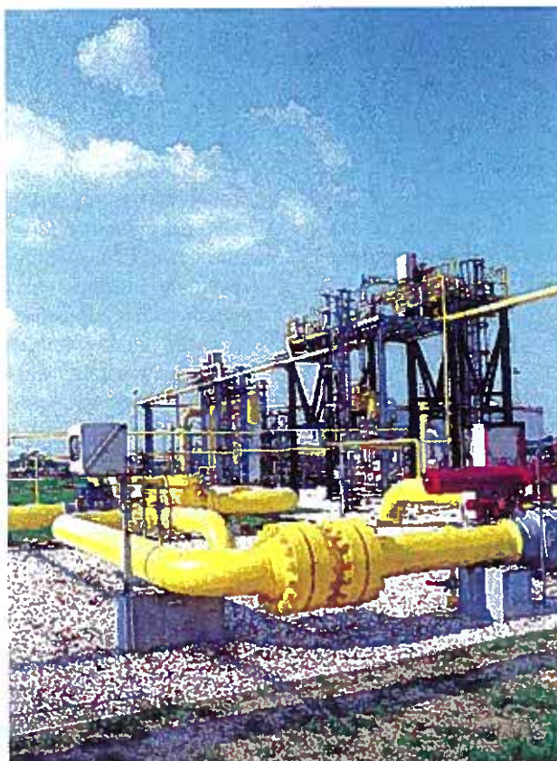
Przygotowanie gazu do transportu (PGNiG S.A.)
