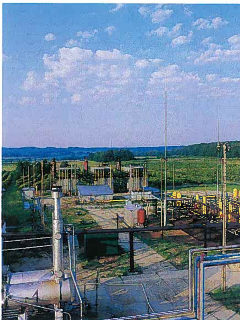
Instalacja kopalni gazu ziemnego PGNiG S.A.
