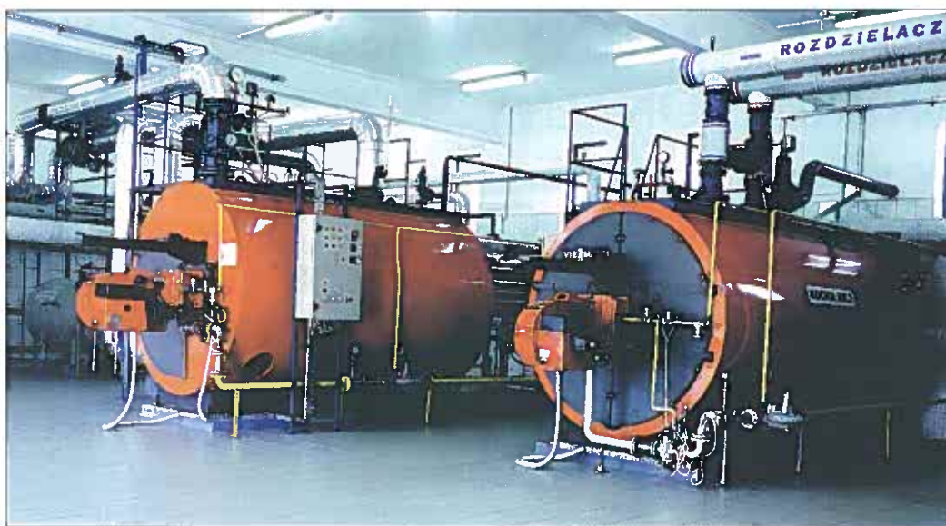
Zespół kotłów szczytowych
