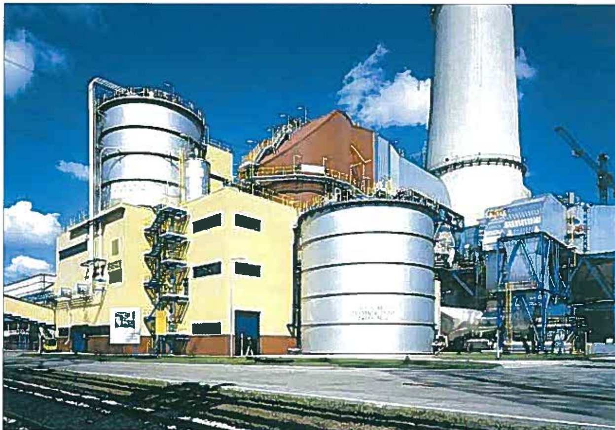
Elektrownia Kozienice SA
