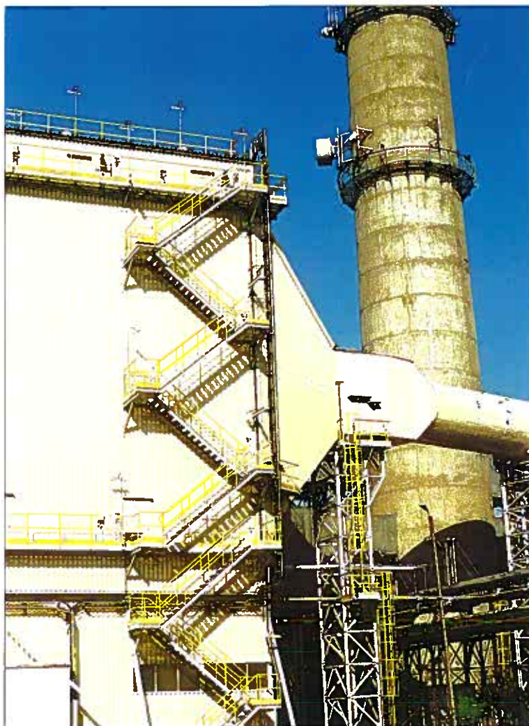
Elektrofiltr kotłów OP-130 nr 6 i 7. Elektrociepłownia Elbląg Sp. z o.o.
