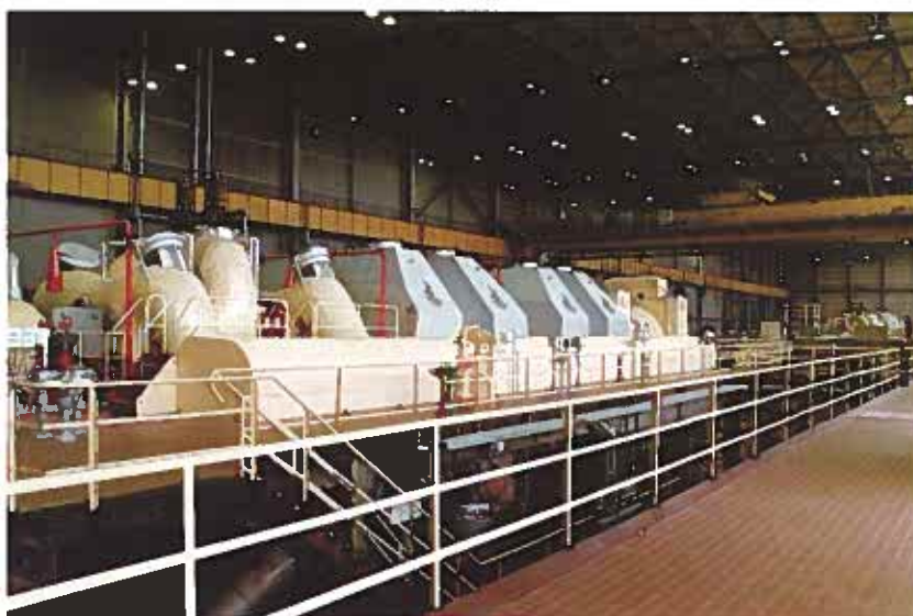
Elektrownia Kozienice – maszynownia
