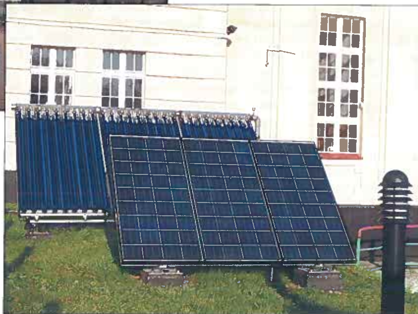
Elektrownia Wodna spółki ENWOD – Gałąźnia Mała, z kolektorami do absorpcji ciepła i ogniwami fotowoltaicznymi
